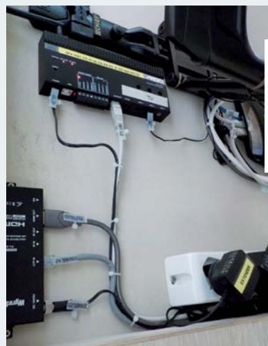
Dietro ad ogni display è stata ricavato un vano che contiene l'elettronica della stanza
